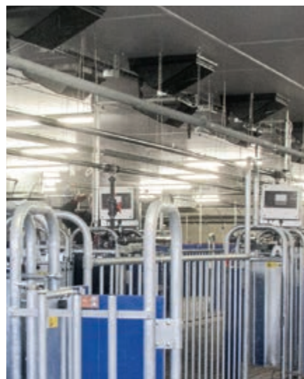
Chauffage des bâtiments avec un radiateur à ailettes – utilisation idéale en combinaison avec les trappes d'admission
