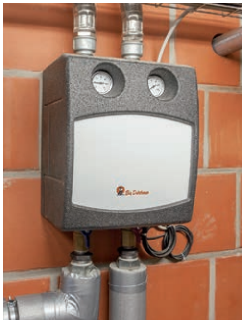
Réglage du chauffage à 3 voies
